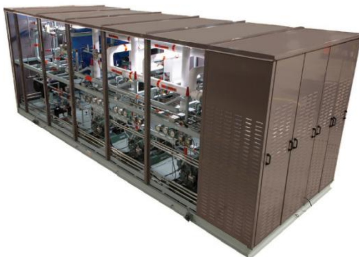
Ammonia CO2 Cascade
