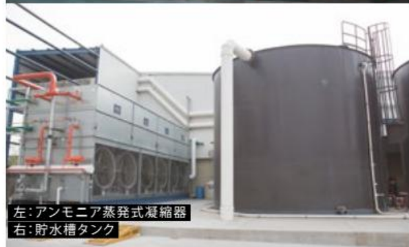
アンモニア/CO 2 カスケードコンデンサーと ポンプステーション
