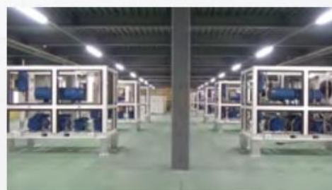
CO 2 機専用工場内部
