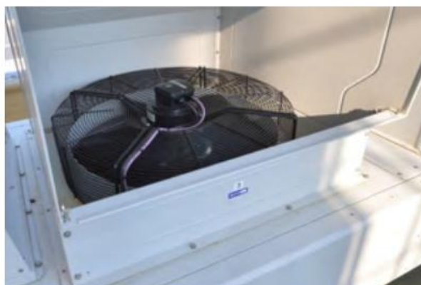
屋上に設置されたユニットクーラー
