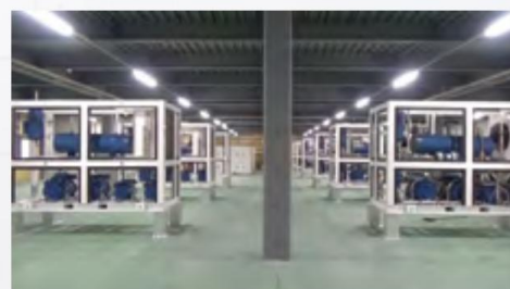
CO 2 機専用工場内部
