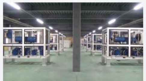
CO 2 機専用工場内部
