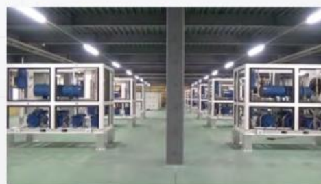
CO 2 機専用工場内部
