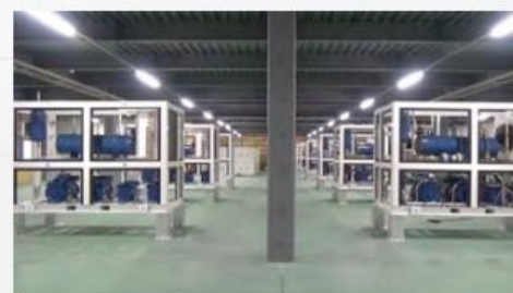
CO 2 機専用工場内部
