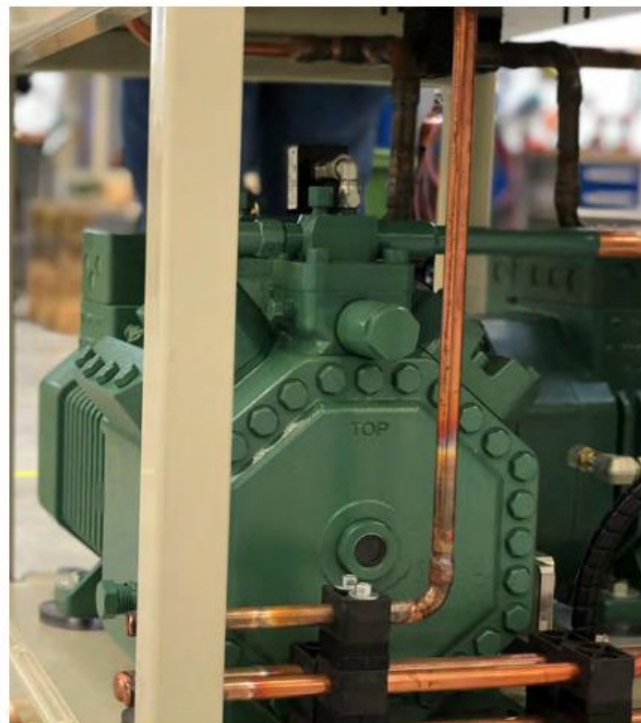
CO 2 コンプレッサー
