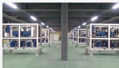
CO 2 機専用工場内部
