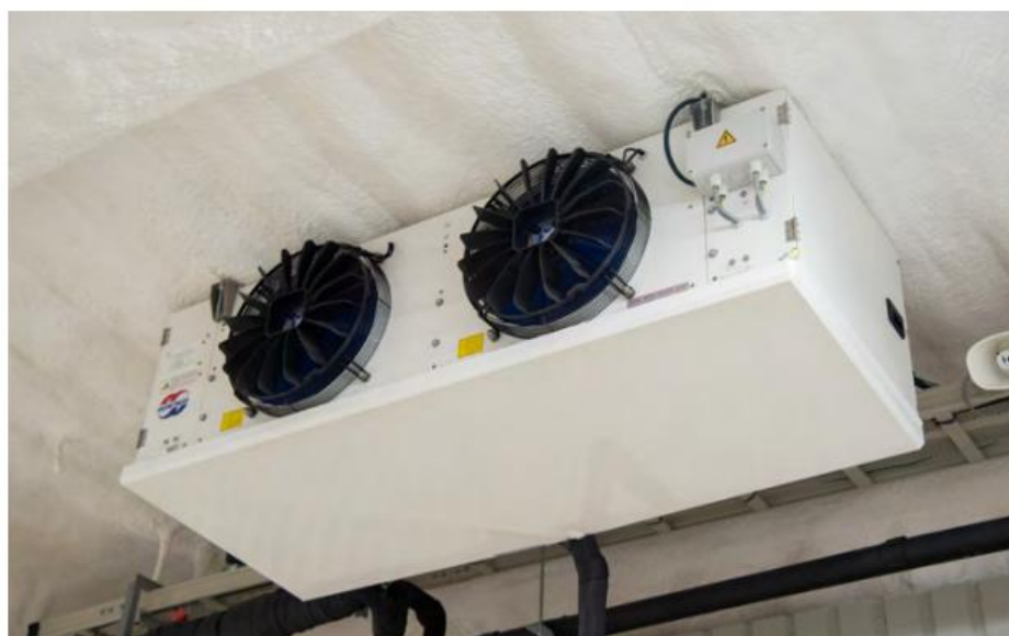
庫内で稼働する Güntner 製 CO 2 ユニットクーラー
