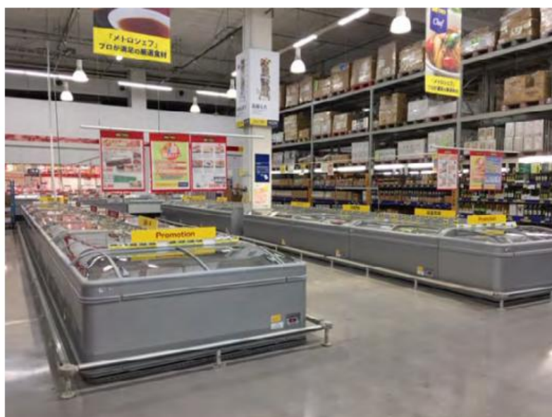
メトロ キャッシュ アンド キャリー ジャパン株式会社 店内に設置された R290 内蔵ショーケース
