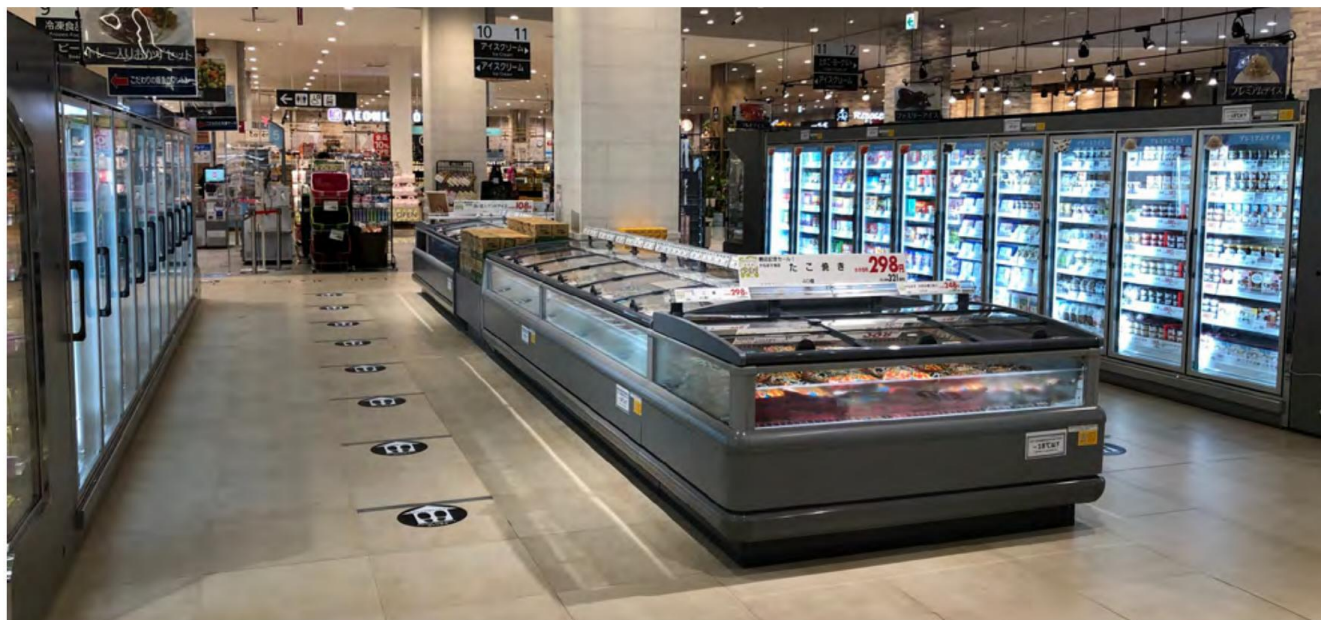
店内に設置された自然冷媒ショーケース
