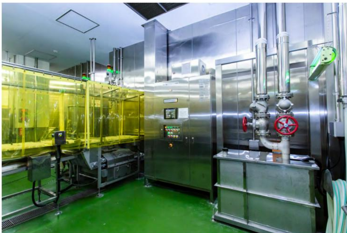
味の素冷凍食品・関東工場の製造ライン内に設置されたスパイラルフリーザー
