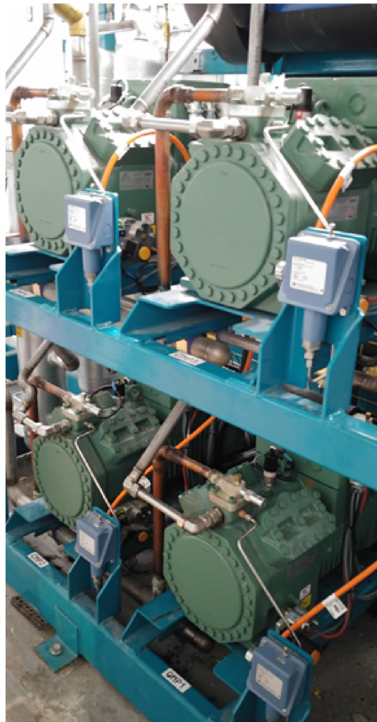
CO 2 rack at Centre Sportif Sainte-Anne-Des-Plaines
